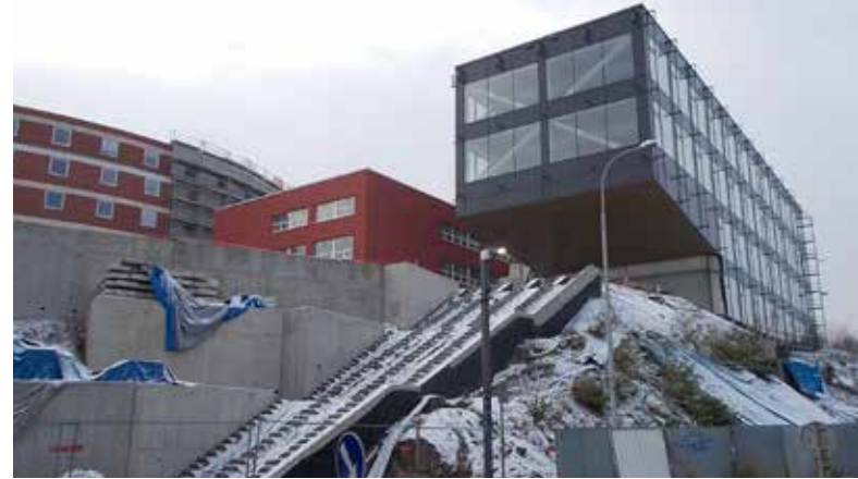
DAS NEUE GEBÄUDE DER FAKULTÄT FÜR SOZIALWISSENSCHAFTEN IN DER U-KŘÍŽE-STRASSE IM AUFBAU
